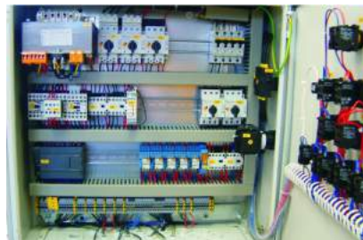
Contrôle PLC / Armoire électrique
